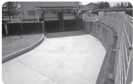
柳原排水機場の導水路
